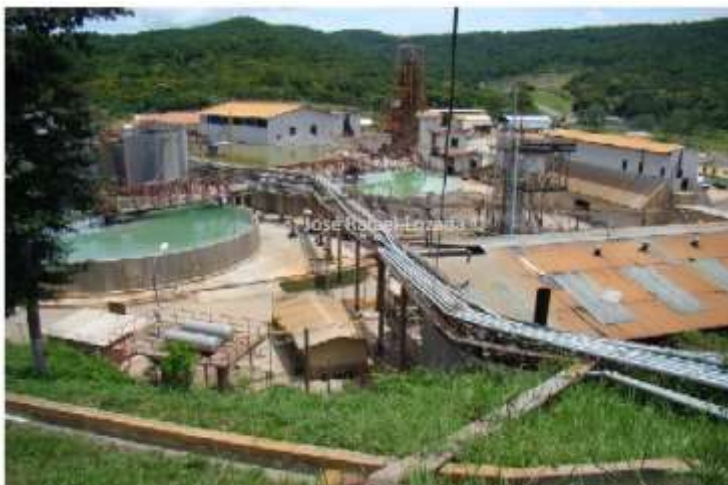
Figura 10. Planta procesadora de Minerven en El Callao; se observan los tanques para el tratamiento de aguas residuales contaminadas con cianuro.
